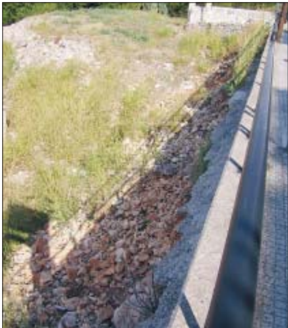
A RISCHIO Il muro di contenimento di via De Gasperi
